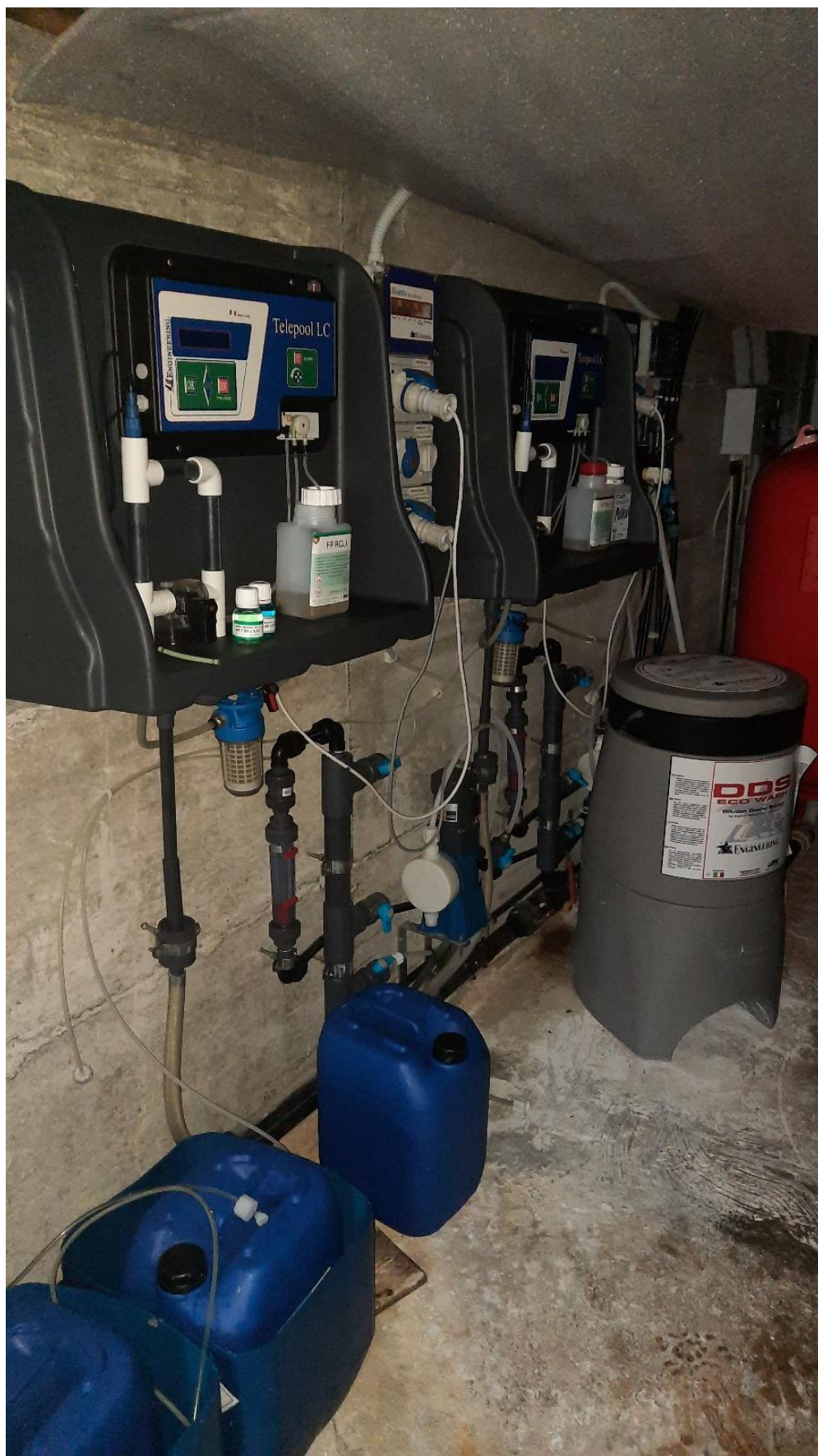
Foto 5 – Locale tecnico – centralina cloro
