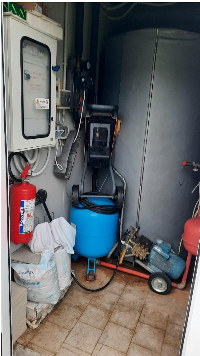
Foto 2 – Centrale termica piscina
