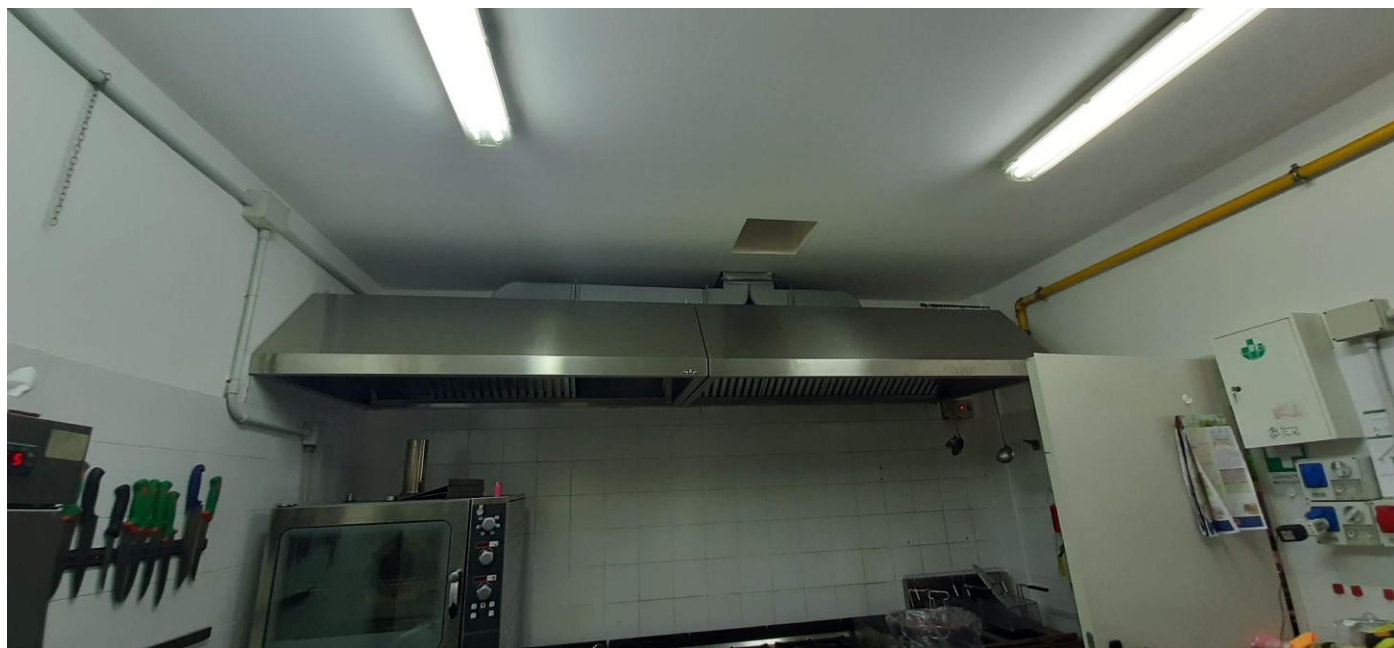
Figura 23 – n. 2 cappe aspiranti (un motore unico)
