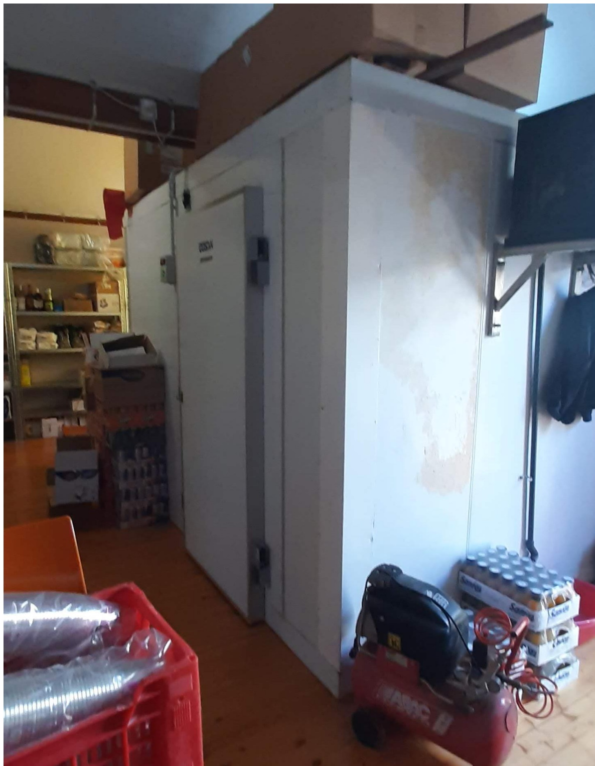
Figura 39 – n.1 Cella Frigo Costan
