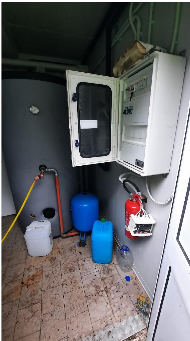
Foto 3 – Centrale Termica spogliatoi polivalente
